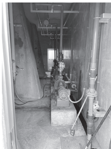
ブロワー機の確認
